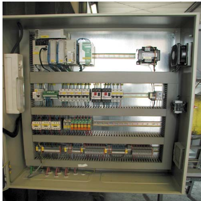
BIS 200, 75 kg/h Control Panel Inside (Dubai)
