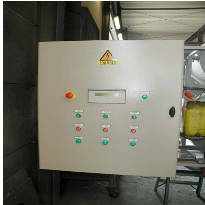
BIS 200, 75 kg/h Control Panel (Dubai)
